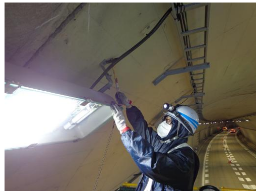
金剛寺山トンネル(照明)
