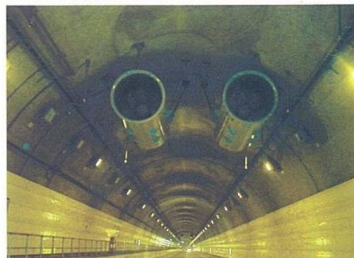
写真2 高速4号線ジェットファン
