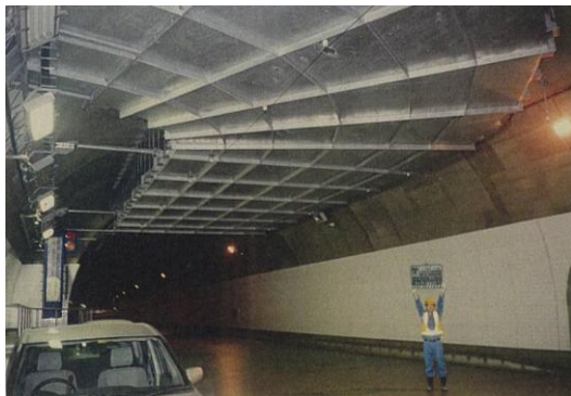
写真1 高速4号線電気集塵機排気ダクト
